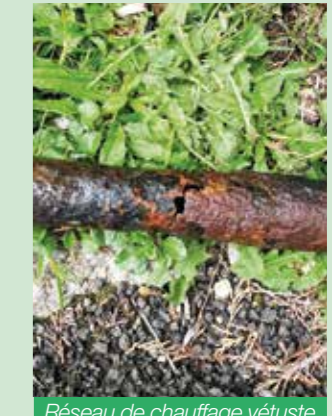
Réseau de chauffage vétuste
